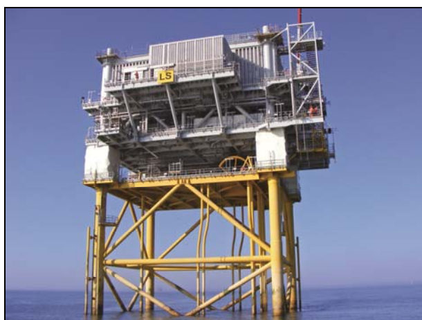
Figure 5 : Une illustration de la sous-station électrique envisagée (STX)
